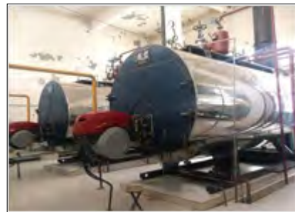
集中熱供給 (天然ガス) ボイラー (阿図什市)
