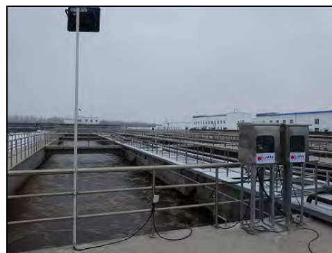
奎屯市汚水処理場（活性汚泥槽）
