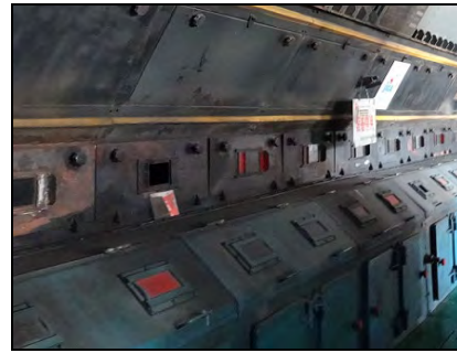
辛家営熱源 B 工場のボイラー (フフホト市城發投資經營有限責任公司)
