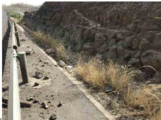
写真1 土砂とゴミに覆われた排水施設
