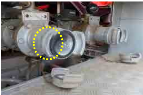
ホース接続部分の腐食
