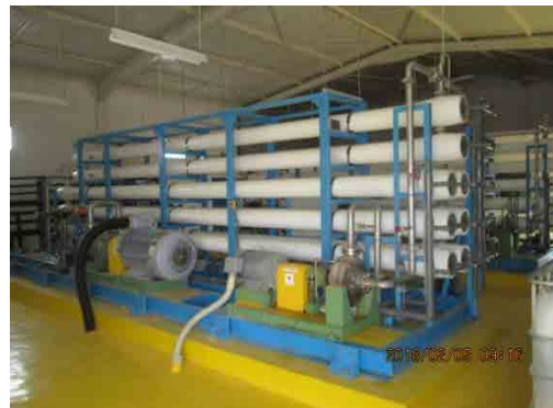
本事業により整備された淡水化施設
