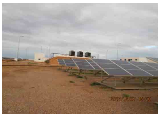
写真2：太陽光発電システム
