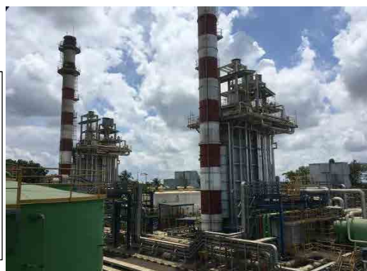
本事業により整備された発電施設
