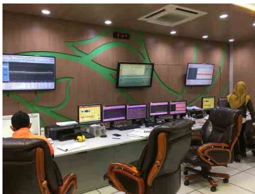
写真 1：本事業発電施設の管理制御室
