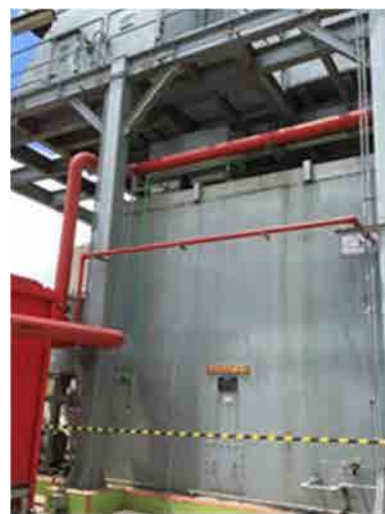
写真 2：ガスタービン用発電装置 1 号機
