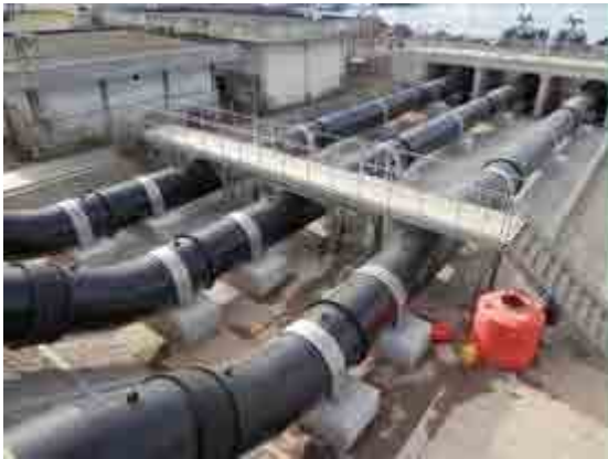
写真3：プルート東排水機場 地上配管方式になった排水パイプ
