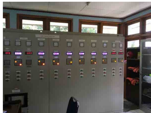
写真 2: ババット堰の水門制御室
