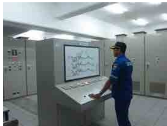
写真 5：東排水機場建屋内でポンプ操作するオペレーター
