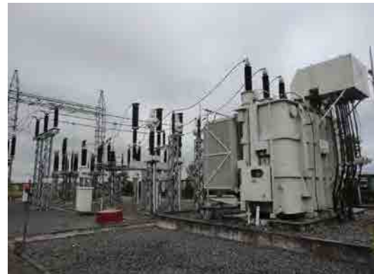
Hoa Khanh 2 Substation (Da Nang City)
