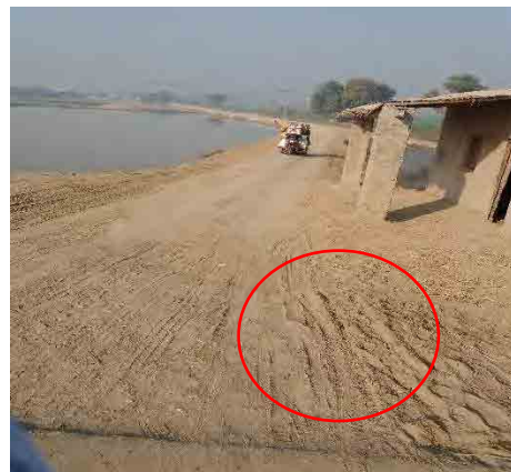
Bad condition road Dadu (DA - 3)
