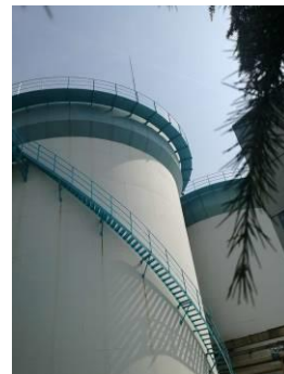
ガス生産事業部門の発酵タンク 第二次調査時（2018年3月）
