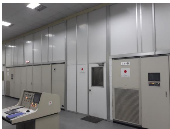
ファキラバード送信所 500kW 中波送信機
