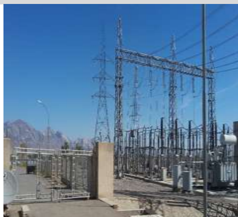
クズダール変電所の新設設備：220kV受電回路 3
