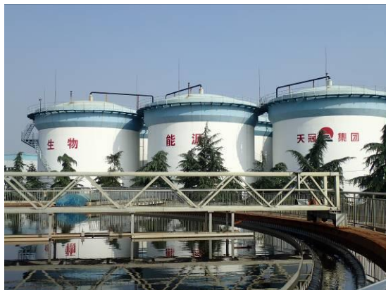
ガス生産施設
