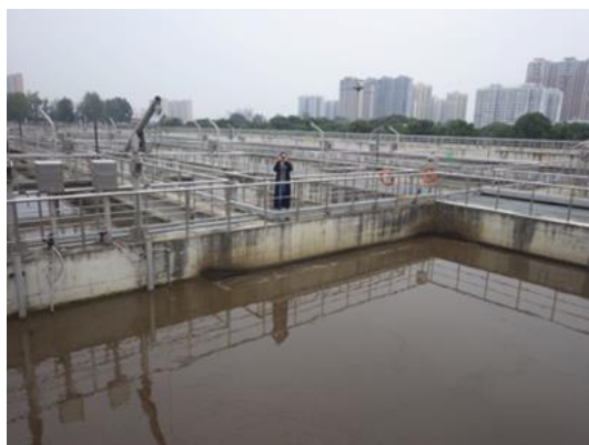
北区下水処理場のエアレーションタンク (改良型 A 2 O 法を実施)
