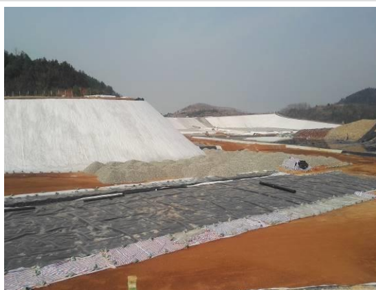
本事業で建設された埋立処分場（華容）
