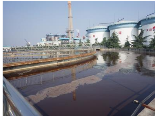
ガス生産事業の排水処理
