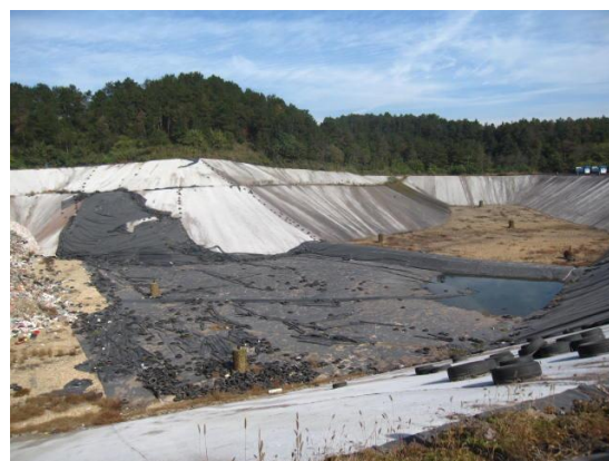
本事業で建設された埋立処分場 (霍山)
