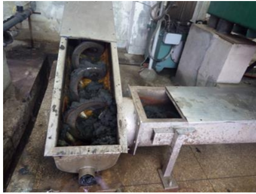
北区下水処理場の汚泥脱水処理
