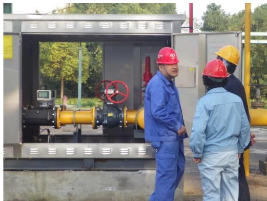
ガス供給レギュレーターステーション
