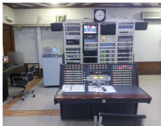
イスラマバード本局主調整室
