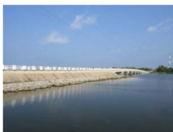
架替え後のパニチャンカニ・ コースウェイ及び橋 (No.5 橋梁)
