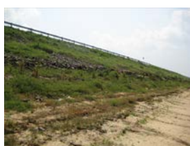
東部州アンパラ県の貯水 池堤防 (Namal Oya Irrigation Scheme)
