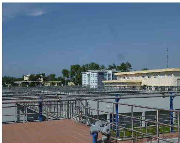
ドンナイ省において整備された浄水処理施設
