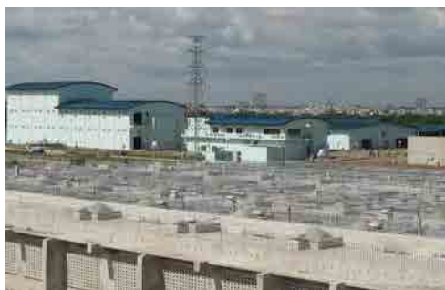
建設された Binh Hung 下水処理場
