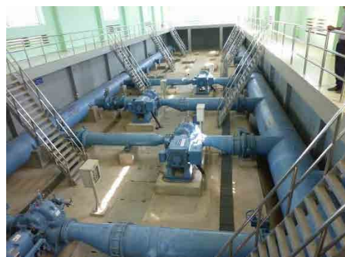
写真 1：ドンナイ省で建設された送水ポンプ場
