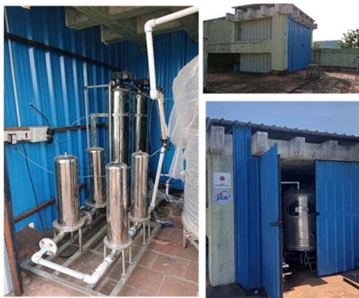
図 3-23 SG&SWRDC ビル屋上に設置された浄化装置
