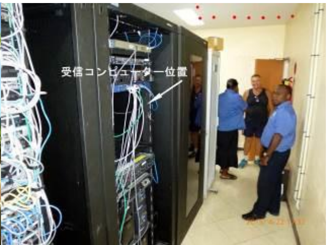
⑭ バヌアツ気象局 サーバーールーム 気象局のサーバーールーム。ラックマウントタイプの PC を希望。
