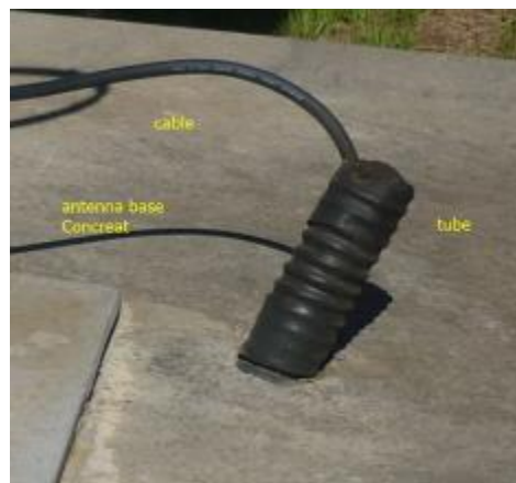
(c) アンテナベースのケーブル導入口
