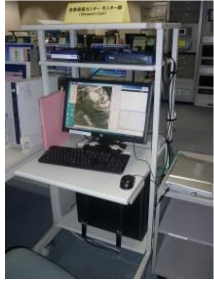
② JMA（清瀬衛星センター）受信機・SATAID 表示端末 アンテナから導入された信号線は、ラック最上段左の信号処理機を経て、ルーター（最上段右）に入り、PCで受信処理される。PCにはSATAID（ソフトウェア）がinstallされている。
