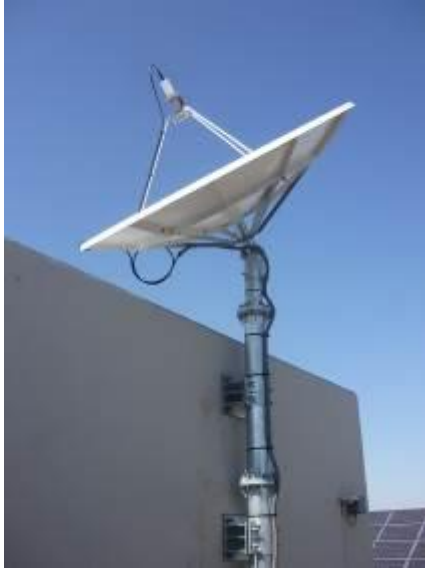
① JMA（清瀬衛星センター）アンテナ アンテナを取り付けたポールを屋上のコンクリート構造物に固定して設置。
