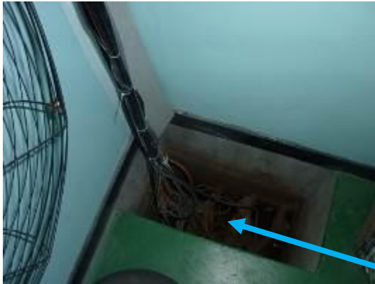
(e) 屋内へのケーブル導入部
