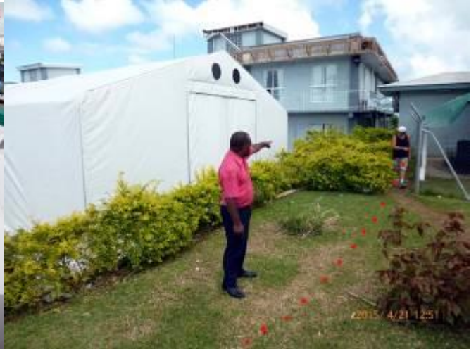
⑫ バヌアツ気象局 ケーブル線経路 左写真のアンテナ設置箇所から、芝生の下に地下埋設し、気象局建屋までケーブルを導入。
