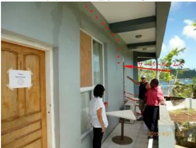
⑬ バヌアツ気象局 ケーブル導入箇所 壁の内側が予報作業室のサーバーールームとなっており、壁に穴を開けて屋内へケーブルを導入（現在あるエアコンの排気口の下）。
