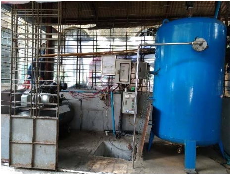
コンプレッサーとエアタンク
