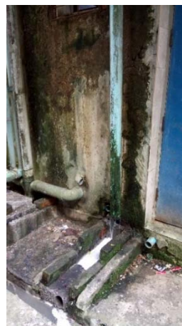
写真 4.1.5 既存排水管(雨水と雑排水)
