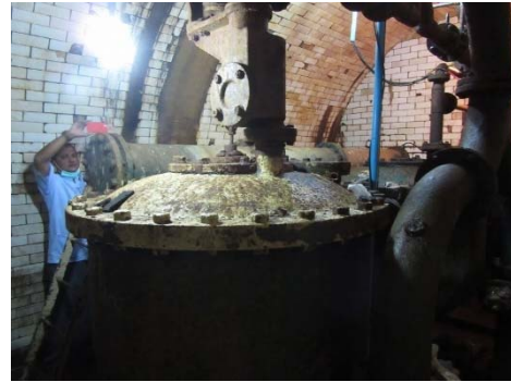
マンホール内の下水タンク
