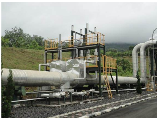
主蒸気隔離弁
