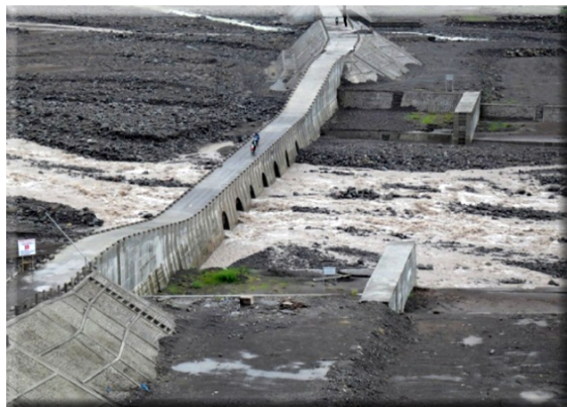
(床固め工 <Consolidation Dam> : バワカラエン山事業)
