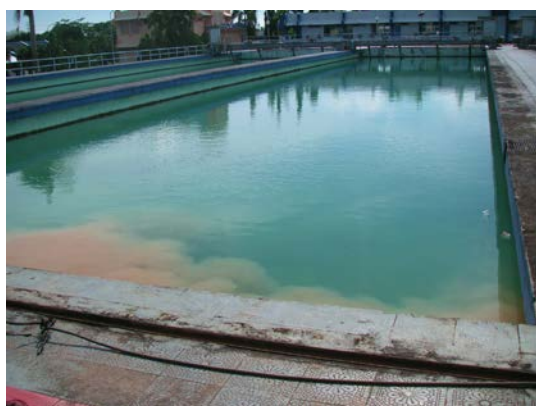
浄水場沈砂池：手前が原水
