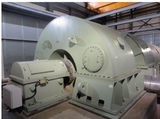
タービン及び発電機
