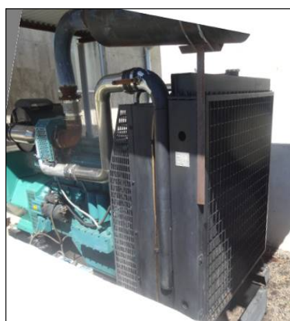
ピラル浄水場の 自家発電機
