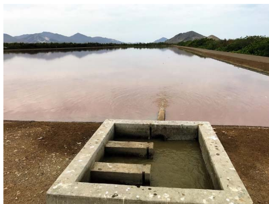
セントロスル下水処理場（チンボテ市）
