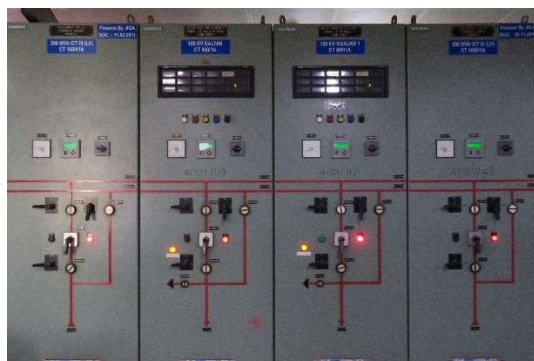
制御盤（カルワ変電所、ワシ管区）
