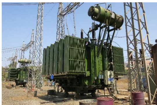
変圧器（ロナワラ変電所、プネ管区）
