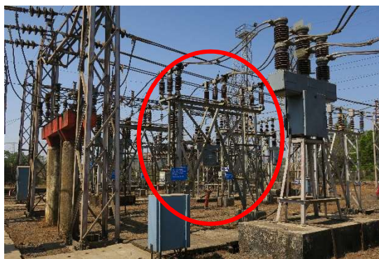
断路器（ロナワラ変電所、プネ管区）
