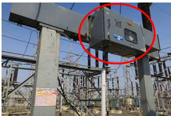
開閉器（タカリ変電所、ナシック管区）
