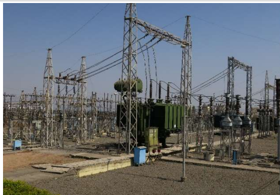
本事業で増強された変電設備 (シルバル変電所、カラド管区)
