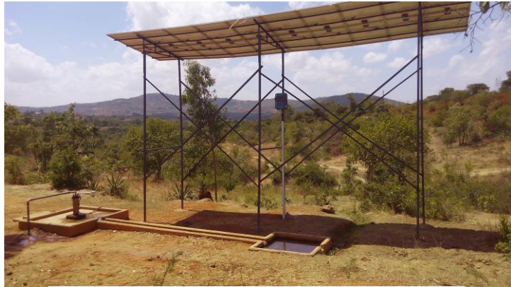
写真 3 リュニ村の給水施設
