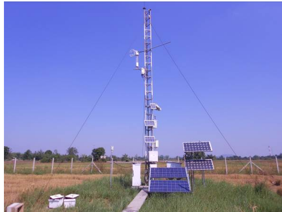
写真 1 ラチャブリに設置された フラックス観測塔
