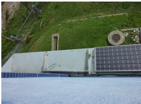
写真 1: 台風 26 号（ニーナ）により被害を受けた太陽光パネル
