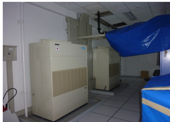
写真 2: 台風 26 号（ニーナ）により施設内天井にひびが入り、時折水漏れが生じている
