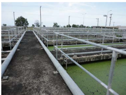
下水処理設備
