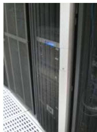
図5 EDC 本部データ管理システム（施錠された状態）
