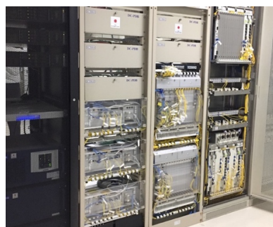
本事業で設置された機材（ネピドー市）
