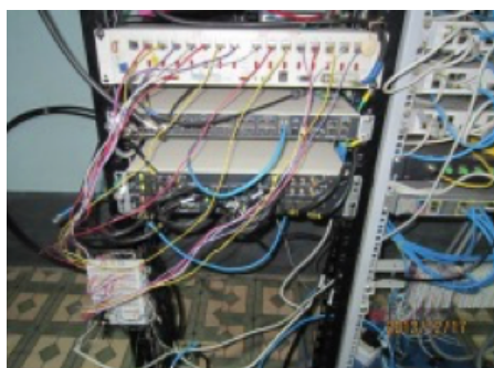
計画時：ラベルがなく、垂れ下がっているためケーブルの行き先の識別が困難。 (写真：JICA 提供資料)
