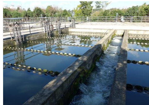
第 6 下水処理場の反応槽
