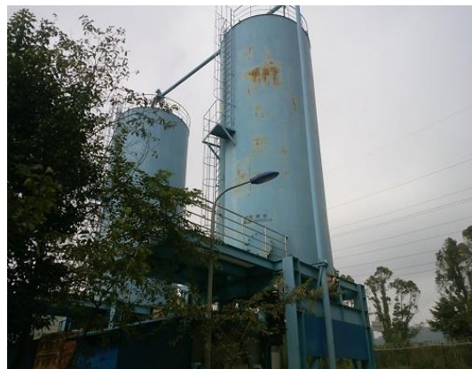
臭気除去施設 (第4下水処理場)
