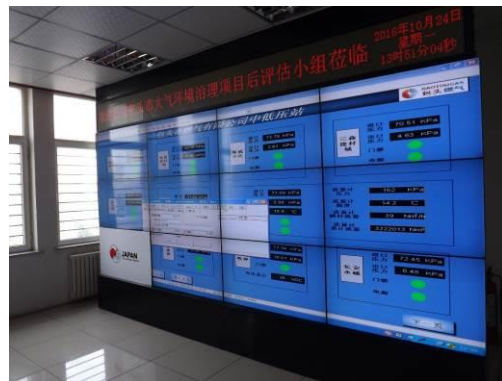
SCADA システム (ガス会社本部に設置)
