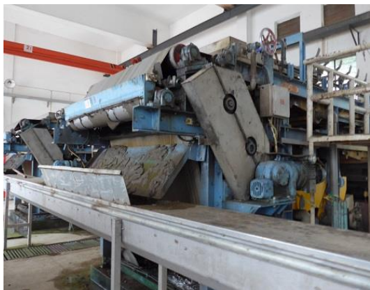
汚泥処理施設 (第1下水処理場)
