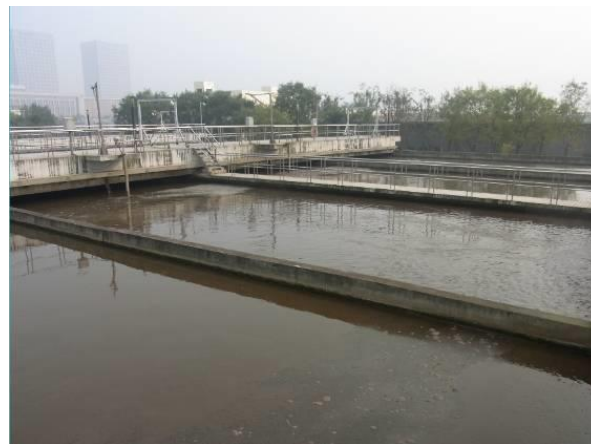
西南郊地区下水処理場の生物反応池
