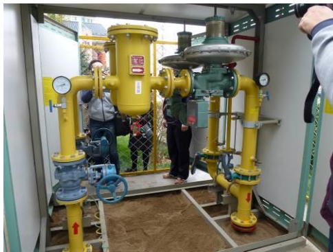
住宅団地に設置の レギュレーターキャビネット
