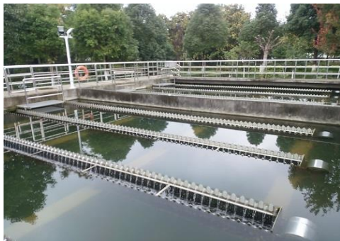
第 5 下水処理場の反応槽
