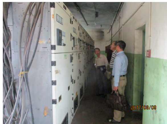
アパパロード変電所（33kV配電盤の様子）
