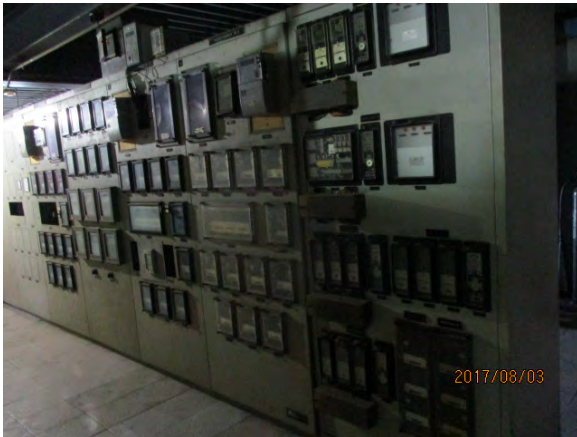
アパパロード変電所（継電器盤の様子）
