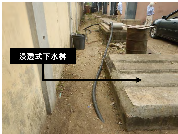
図 2-2-3 アパパロード変電所の浸透式下水枞
