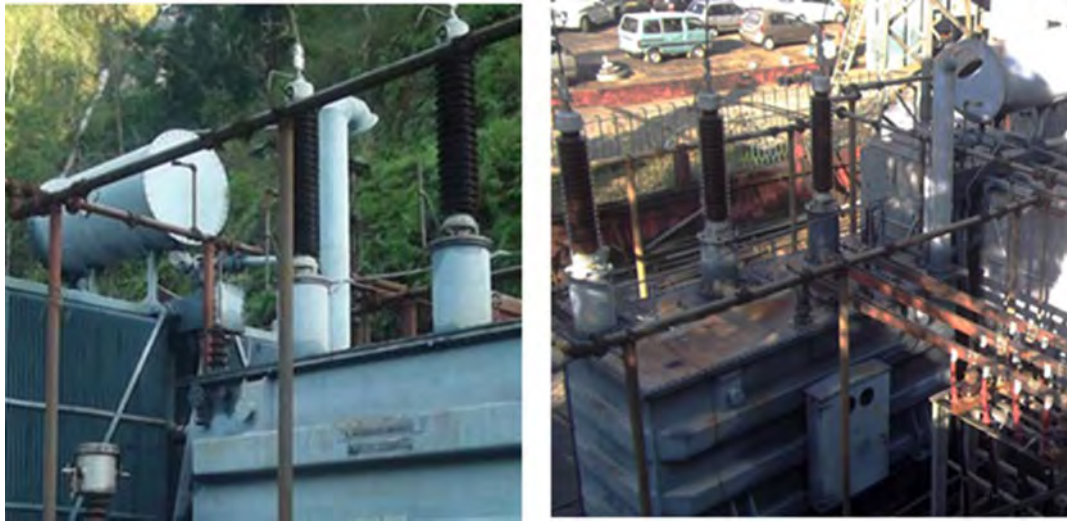
(左：タンク、ブッシング、ラジエターからの漏油 右：タンク、ラジエターの発錆)
