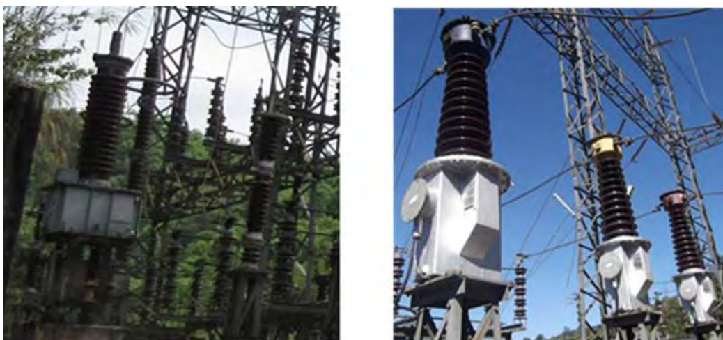
(左：132kV 計器用変圧器 右：132kV 計器用変流器)
