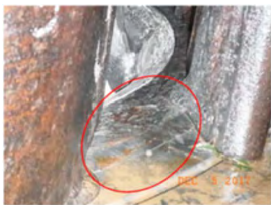
シートライナの損傷
