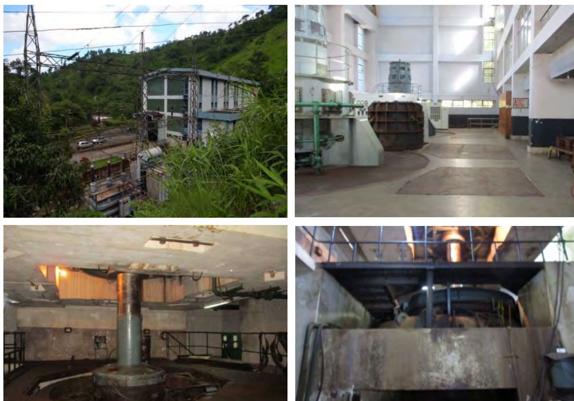
左上より時計周りで、発電所全景、組立てフロア、 水車フロア、水車（下部埋設）
