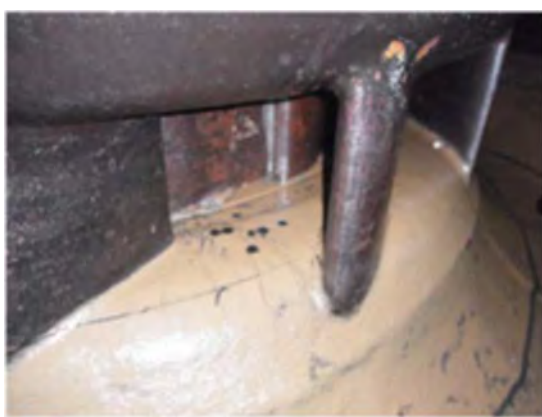
ステイリングとステイバーン (2号機のケーシング内部)
