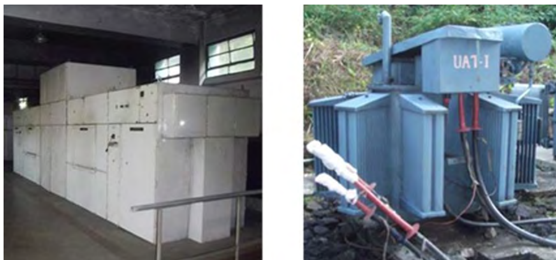
(左：11kV キュービクル 右：所内変圧器)
