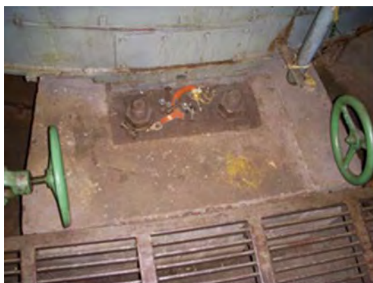
固定子の基礎と基礎ボルト
