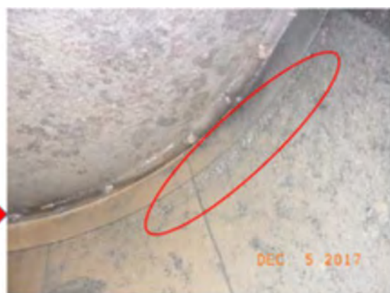
漏水によるキャビテーション壊食
