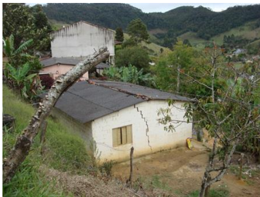
Figura 59: Vista de trinca inclinada em moradia (Foto: Acervo IG, 2008).
