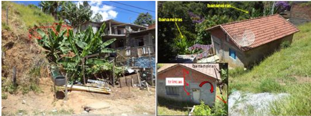
Figura 556: Indícios precursores e deslizamento planar associado ao plantio de bananeiras nas encostas (Foto: Mendes, 2014).
