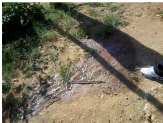
Figura 522: Vazamento em rede de água em talude de corte (Foto: Mendes, 2013).
