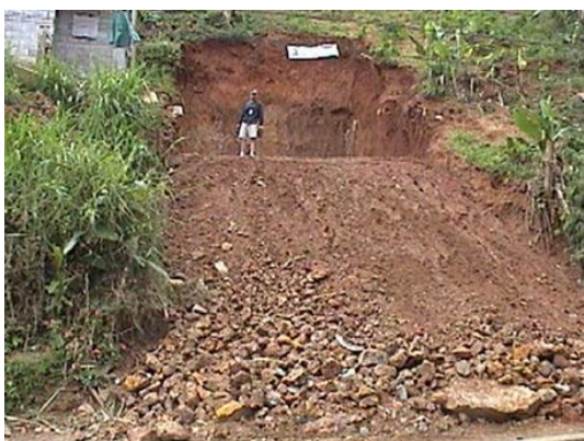
Figura 48: Vista de corte em encosta de área de risco (Foto: Oliveira, 2005).
