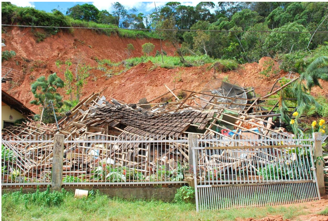
Foto 1 – Mostra a alta vulnerabilidade física da edificação após movimento de massa na área de risco do Bairro Fortaleza Alta, Blumenau/SC. Fonte: Defesa Civil de Blumenau/SC, 2017.
