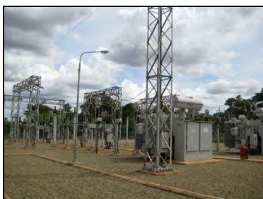
マクユニ変電所（新設）
