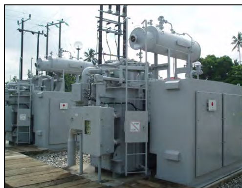
新設されたウェレゾ変電所(33/11kV) の主変圧器
