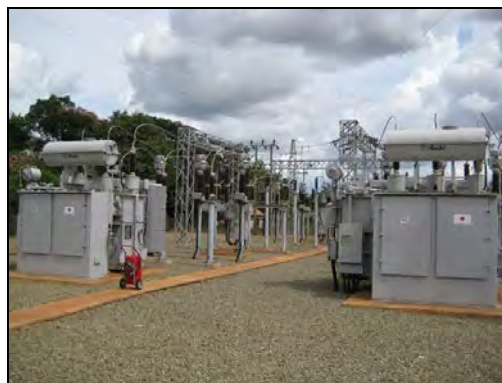
本事業で新設されたマクユニ変電所
