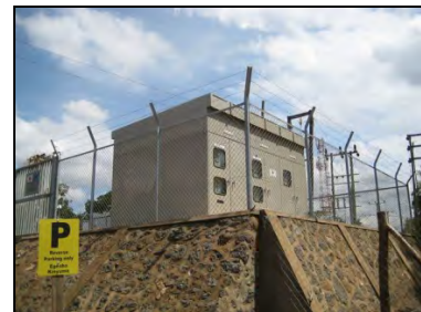
トレードスクール変電所（拡張）
