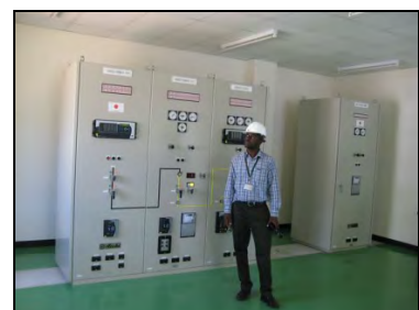
キユンギ変電所 建屋内
