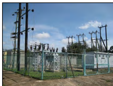
ラワティ変電所（更新）
