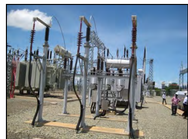
キユンギ変電所（拡張）
