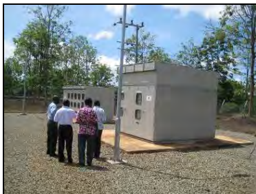
KCMC 変電所（新設）
