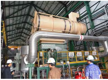
タービン（上）と発電機（下）
