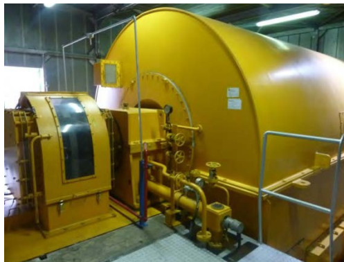
発電所内のタービン
