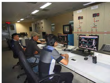
コントロール室
