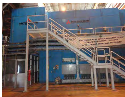
ガスタービンが入っている施設
