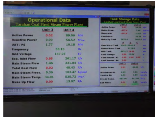
中央管理室でのオペレーション風景（モニター画面）
