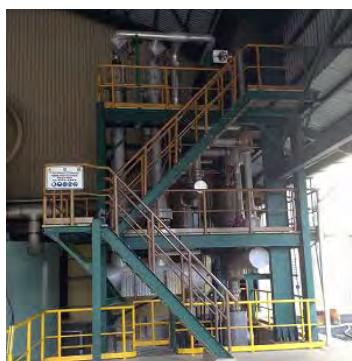
3号機のガス抽出装置
