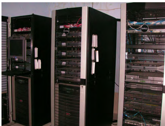
IDC のラックマウントに収められたサーバー等の資機材
