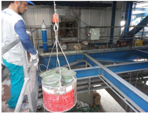
流動床式ボイラーの燃焼媒体（シリカ砂）を運ぶスタッフ
