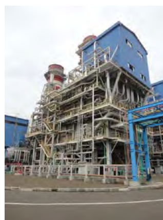
排熱回収ボイラー
