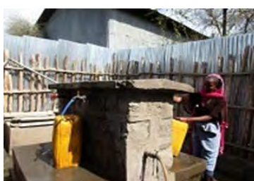
パイプ給水施設 公共水栓
