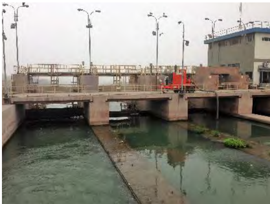
ワチパ浄水場の取水口
