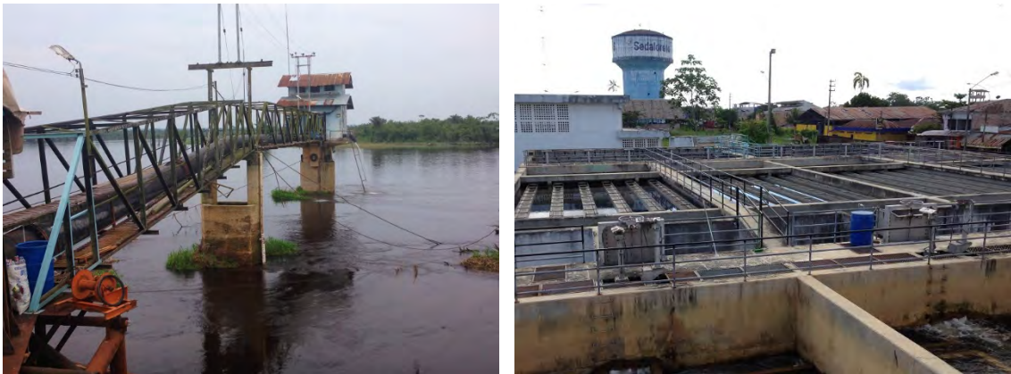
（イキトス）取水口（左）、浄水施設（右）
