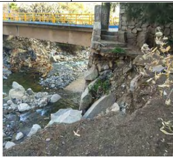
Foto 4: En la foto se puede apreciar como el Rio socaba la estructura del puente cuando hay inundación. Este puente comunica la ciudad de Surco con la carretera principal
