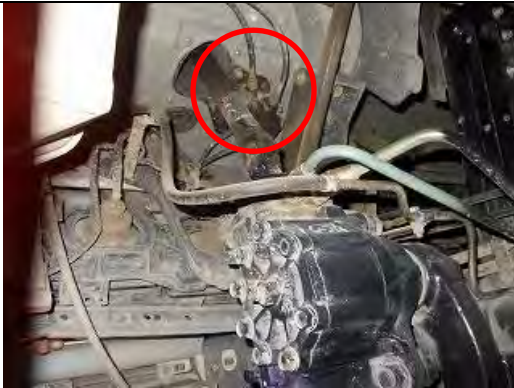
ブレーキバルブからのエア漏れ
