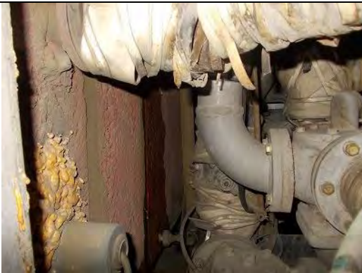
水タンクからの水漏れ
