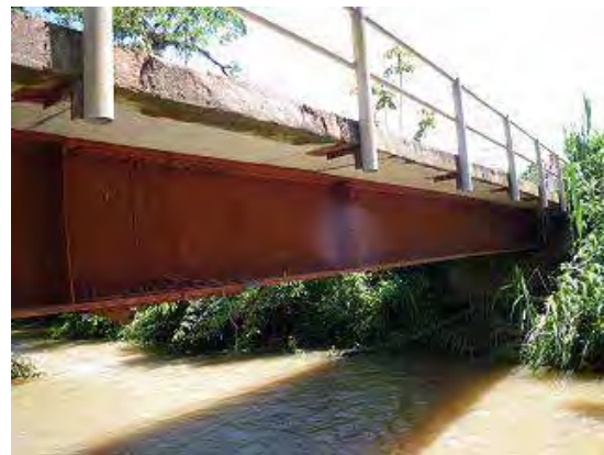
Fotografía 1a-2 Condición de las vigas
