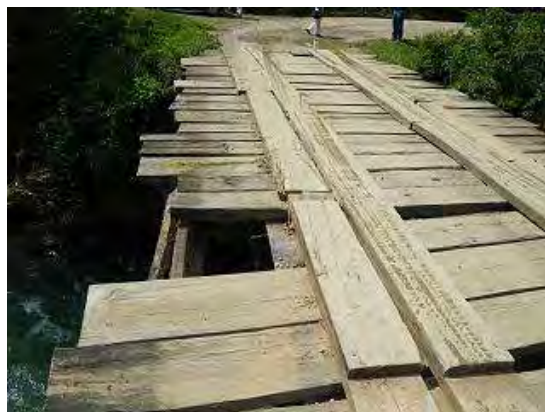
Fotografía 1a-3 Piso de madera dañado
