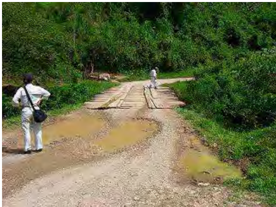
Fotografía 1a-1 Condición de la superficie
