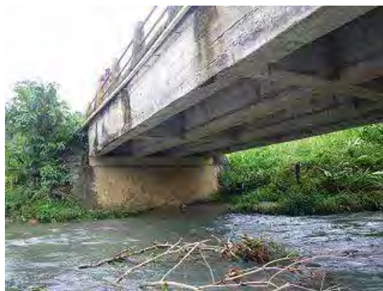
Fotograf1a-3 Condición bajo las vigas
