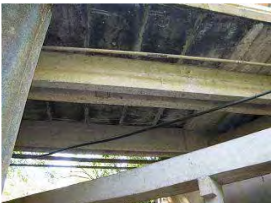
Fotografía 1a-3 Condición abajo de la superficie del puente
