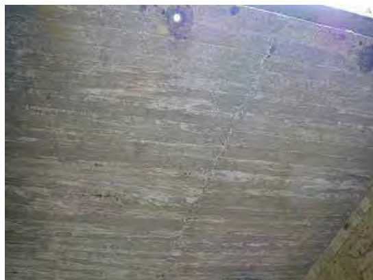
Fotografía 1a-3 Condición bajo la losa
