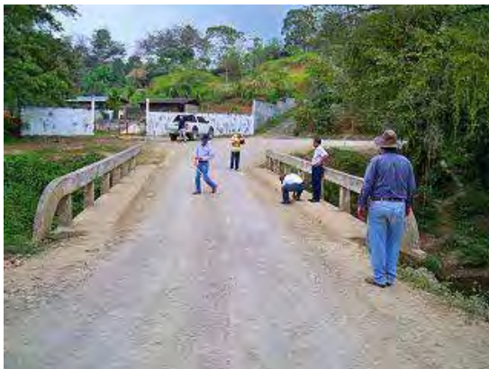
Fotografía 1a-1 Condición de la superficie
