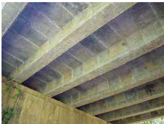
Fotografía1a-3 Condición bajo la losa
