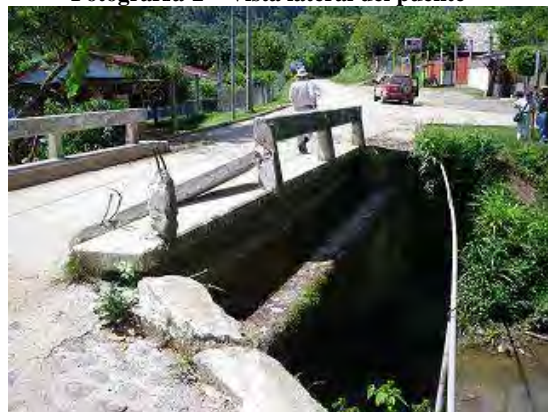
Fotografía 1a-4 Condición del pasamanos, dañado
