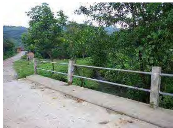
Fotografía 1a-4 Condición de pasamanos dañado
