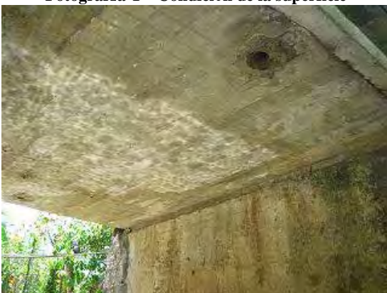
Fotografía 1a-3 Condición bajo la losa
