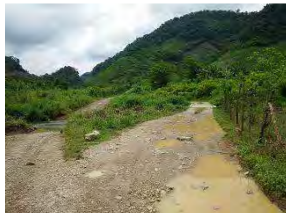
Fotografía-4 Condición del acceso al puente
