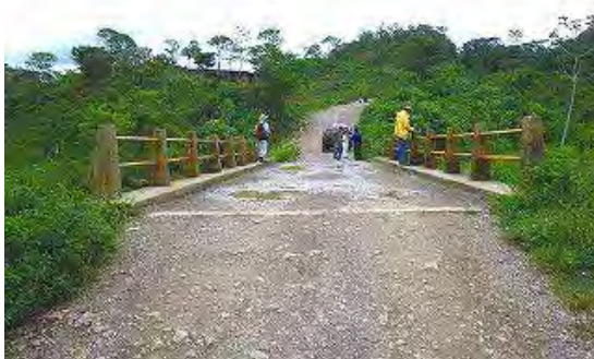
Fotograf1a-1 Condición de la superficie
