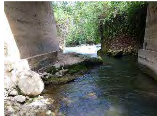
Fotografía 1a-4 Condición del estribo y el lecho del río
