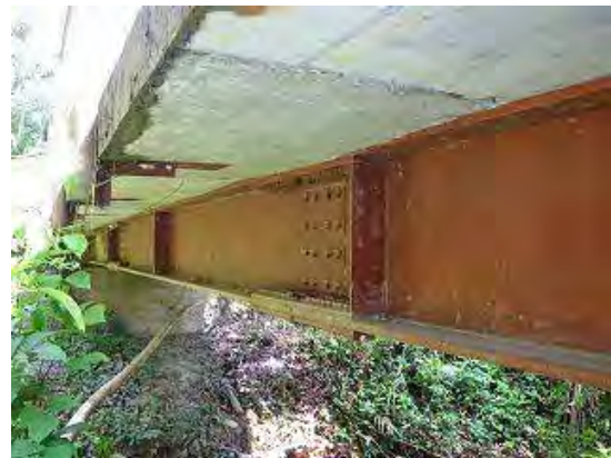
Fotografía 1a-2 Condición de las vigas
