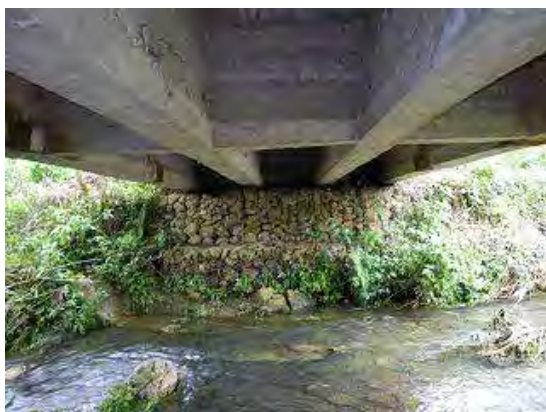
Fotografía 1a-3 Condición bajo las vigas, gaviones al frente de los estribos
