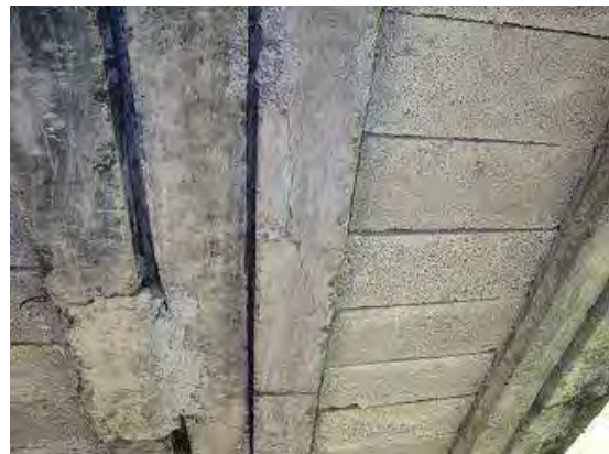
Fotografía 1a-4 Fisuras en viguetas
