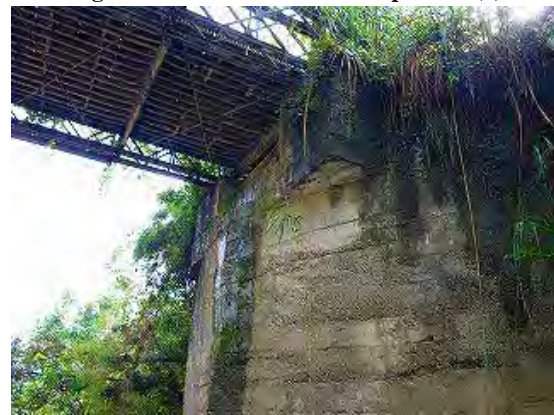
Fotografía-4 Condición de los estribos
