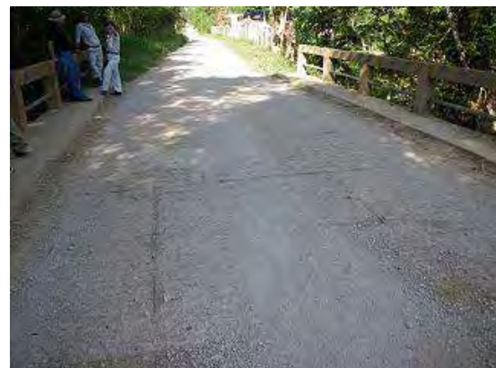
Fotografía 1a-4 Barras expuestas
