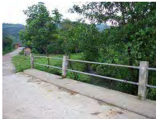
写真-4 高欄損傷状況
