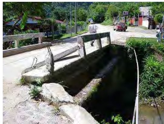
写真-4 高欄損傷状況
