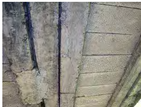
写真-4 主桁損傷状況
