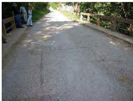
写真-4 床版上面の鉄筋露出状況
