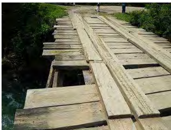
写真-3 木床版損傷状況
