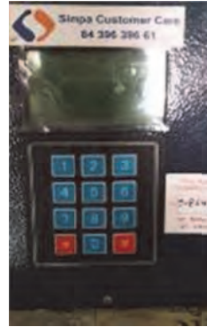
システム付帯の自動制御装置
