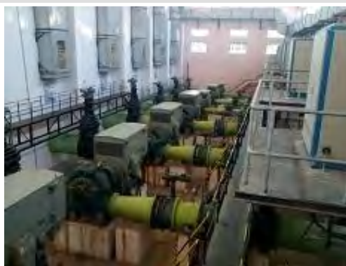
バラワラポンプ場
