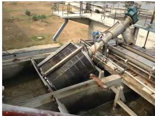
下水処理施設（ケショプール）
