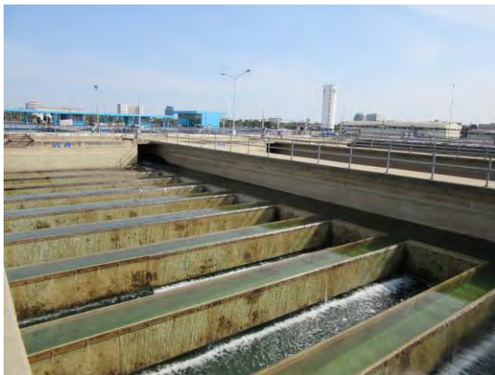
バンケン浄水場（本事業での拡張部分）
