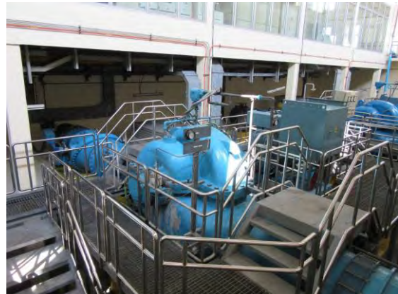
本事業で設置したポンプ （ペッカセム配水場）
