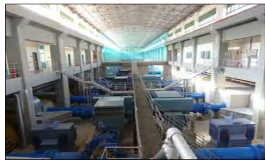
本事業で整備したメレンポンプ場
