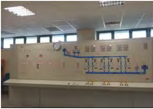
浄水場内コントロールルーム
