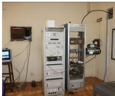
番組入力機器ラック
