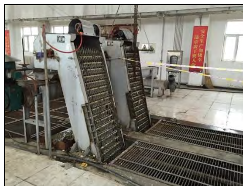
汚水処理場 粗目スクリーン
