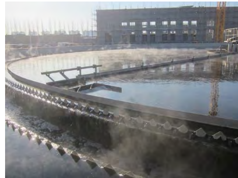
辛辛板下水処理場の沈殿池
