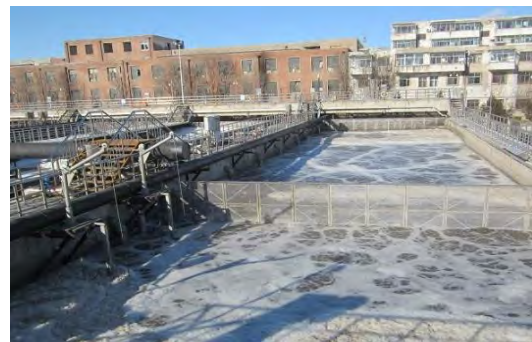
公主府下水処理場の生物反応槽
