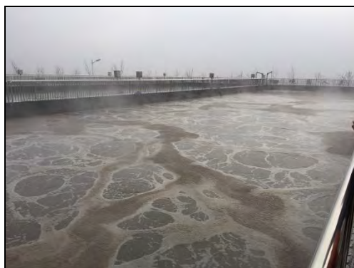
汚水処理場 生物反応池
