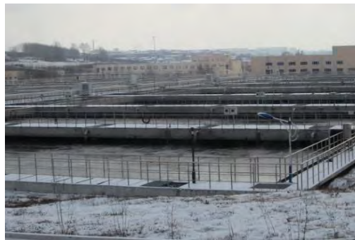
平房下水処理場の反応槽
