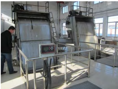
章盖営下水処理場の流入スクリーン
