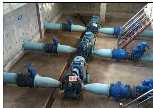
上下水道整備事業で整備された浄水ポンプ
