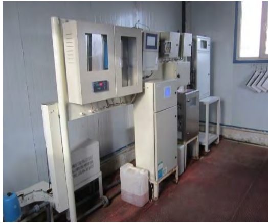
松浦下水処理場の水質モニタリング装置
