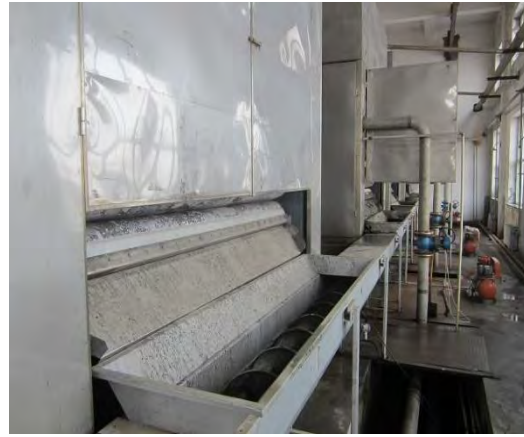
平房下水処理場の汚泥処理施設
