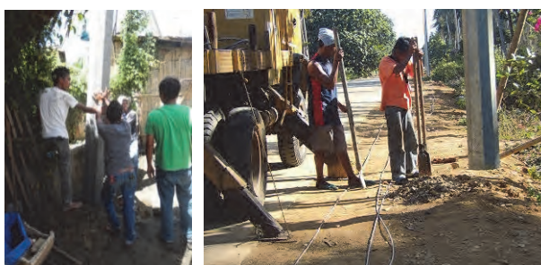
穴掘建柱車がないため、配電柱埋設用の穴掘作業は、ホールディガーを用い、手作業にて行っている。
