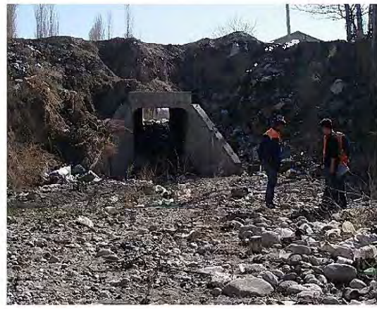
下流側 洗掘進行している状況
