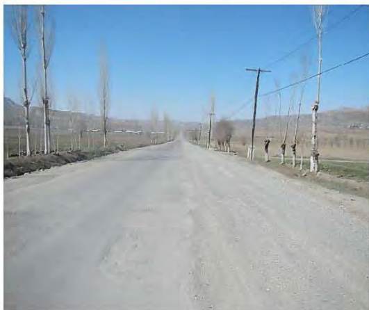
46+000 付近 亀甲状クラック発生
