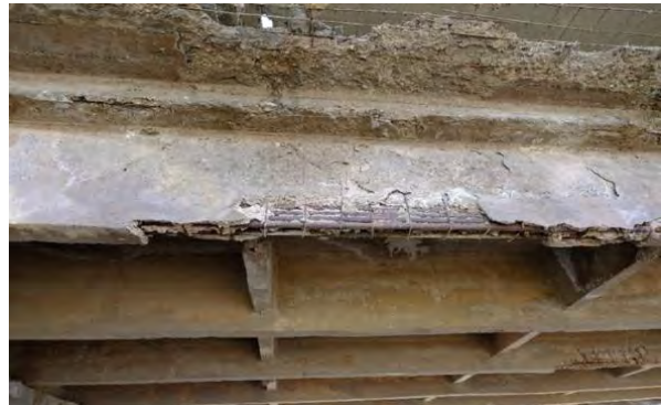
写真 7.2.2 62km+639.37 現橋の損傷・劣化状況
