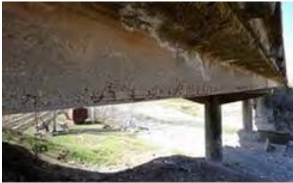
写真 7.2.1 42km+271.71 現橋の損傷・劣化状況
