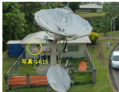
写真-13 ケーブル収容箱位置
