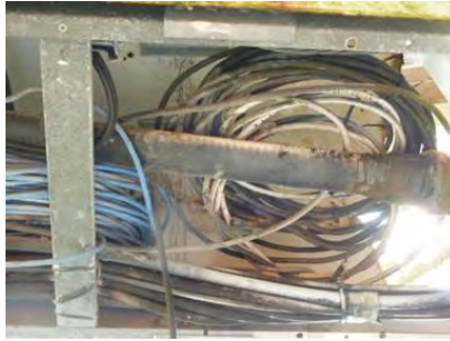
写真-15 ケーブル、導波管被覆の著しい劣化
