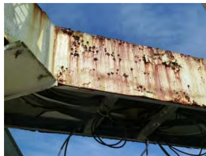
写真-14 ケーブル収容箱カバーの錆による劣化
