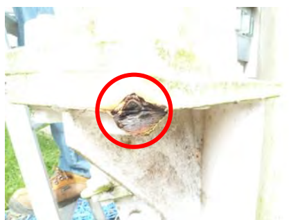
写真-10 Pedestal 部の錆による捲れ
