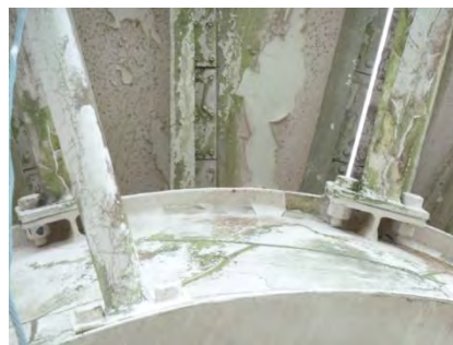
写真-12 主反射鏡背面部・センターハブ外側の塗装剥がれ
