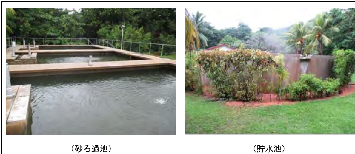
図 2.5.1-3 PUC 所有の地下水濾過施設
