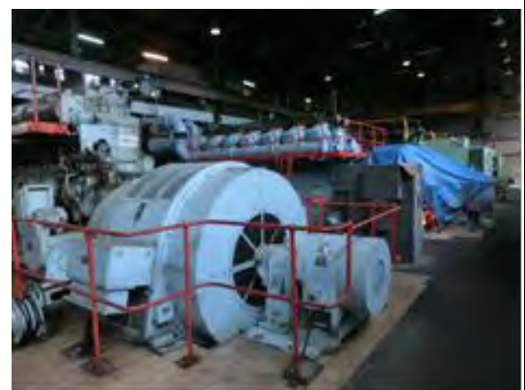
PUC Victoria B 発電所構内 発電機
