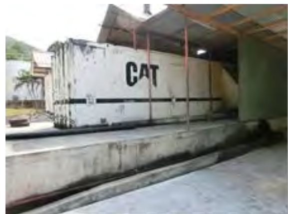
PUC Praslin 発電所 コンテナ型 DG 発電機
