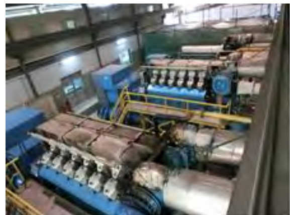
PUC Praslin 発電所 DG 発電機
