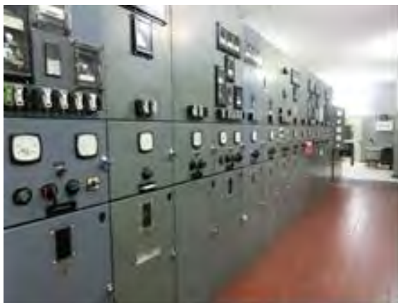
PUC Praslin 発電所 中央制御室 制御盤
