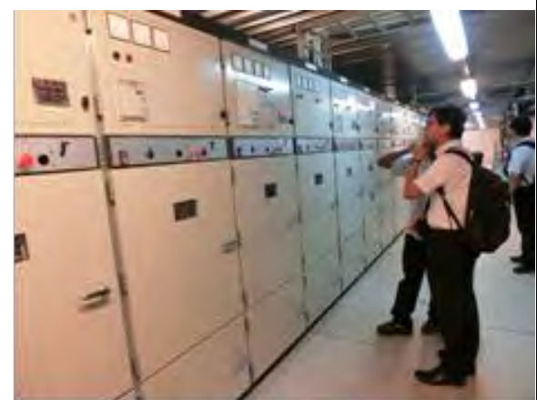
PUC Victoria C 発電所 電気室
