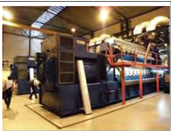
PUC Victoria C 発電所 発電機
