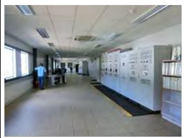
PUC Victoria C 発電所 中央制御室
