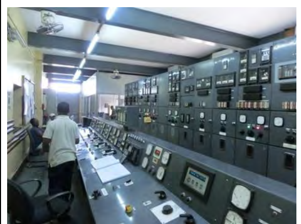
PUC Victoria B 発電所 中央制御室
