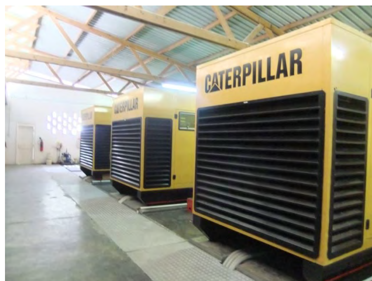
図 2.5.3-4 ディーゼル発電設備
