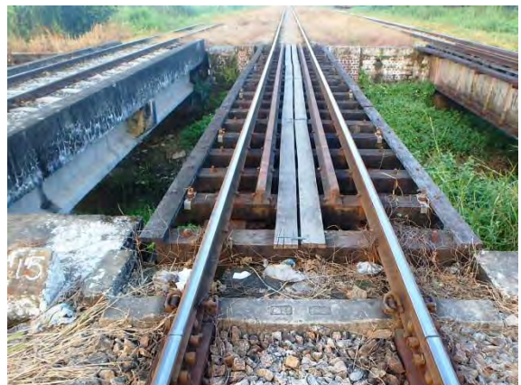
上り線 No15 橋りょうヤンゴン方から(施工前)
