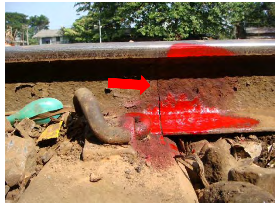
6番線0k207mでレールき裂
