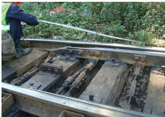
トングレールの擦りへり
