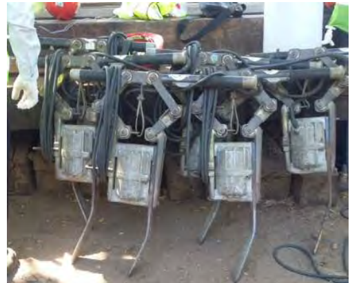
ブレード、ソケットの確認
