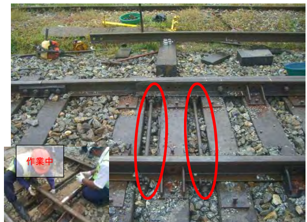
分岐トングレール部鎖錠
