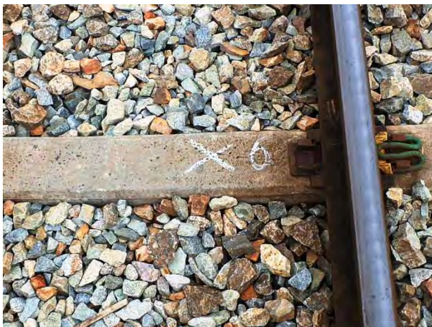
運搬中の治具破損
