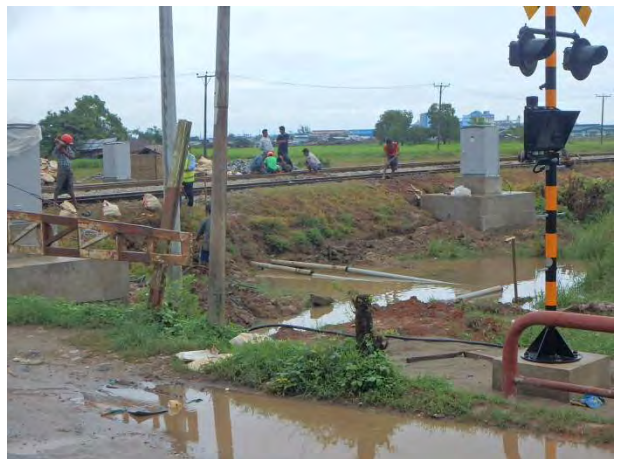
ヤンゴン方機器箱と自動警報装置
