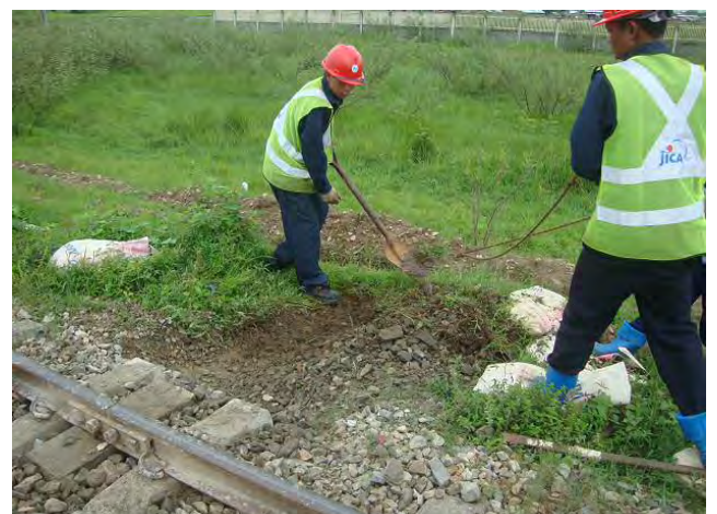
排水処理の状況
