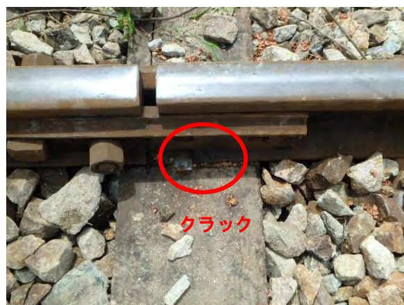
上り線 15k289m レール破損
