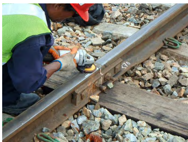
中継レールとの段差解消
