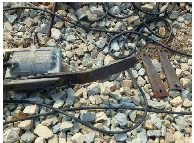
タイタンパーのブレード破損で、2台交換した
