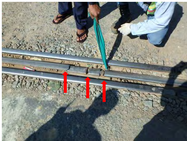
踏切内の縦裂箇所
