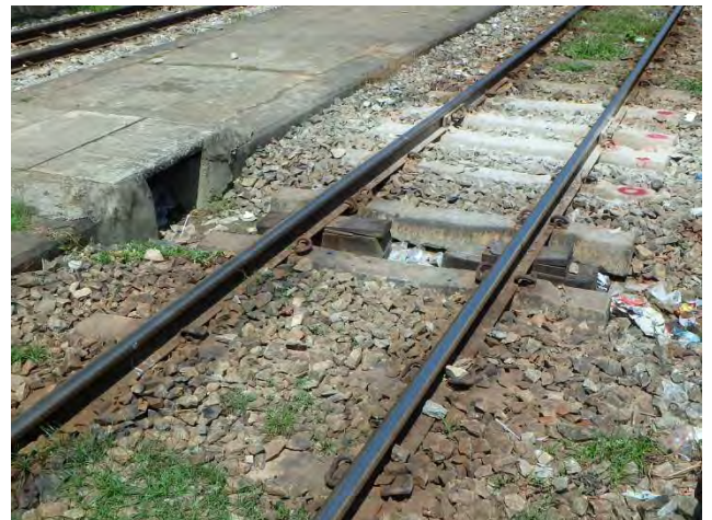
下り線噴泥箇所
