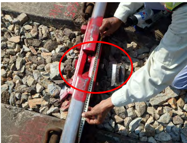
上り線 14 km 665m のレール縦裂(130 mm)
