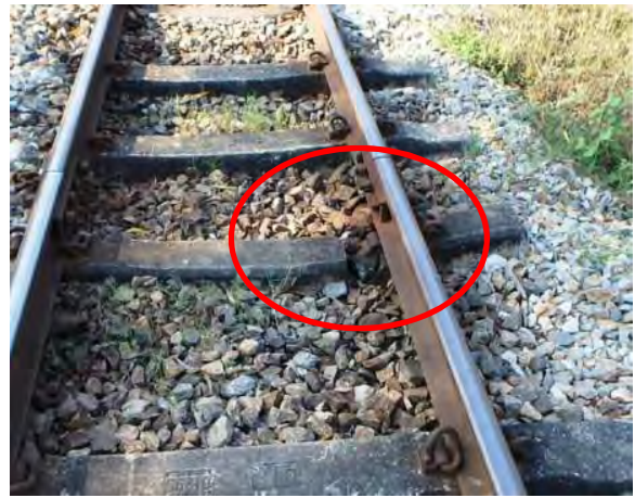
13k200m 付近 P C マクラギの破損
