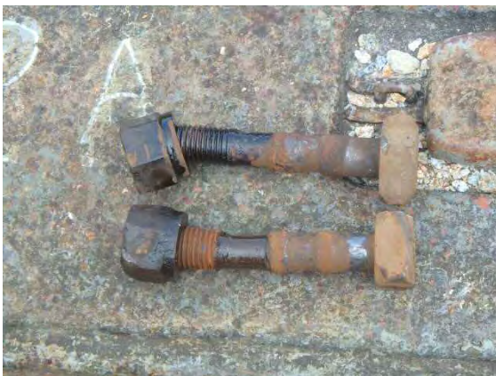
変形した継目ボルト
