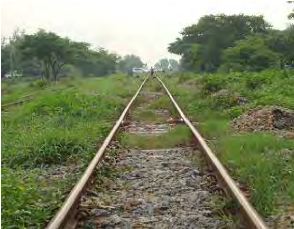
施工前の状況 (軌道内に草が多い)
