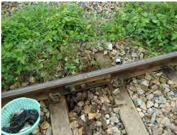
ボルトが外れていた下り線の継ぎ目
