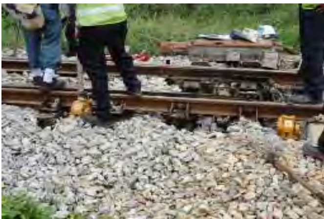
こう上時の不良枕木の状況 (隙間ができる)
