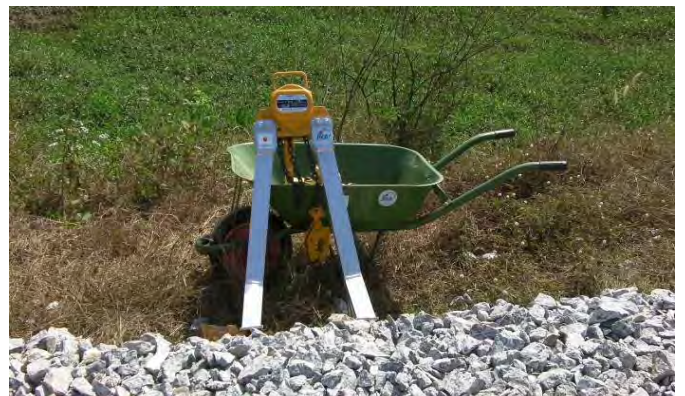
レール吊り上げ器とトロリー（ネコ車）
