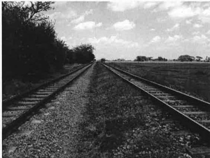
Ballast , Roadbed (ရေပိပ်ခြင်း၊ပုံသဏ္ဍန်မမှန်ခြင်း)
