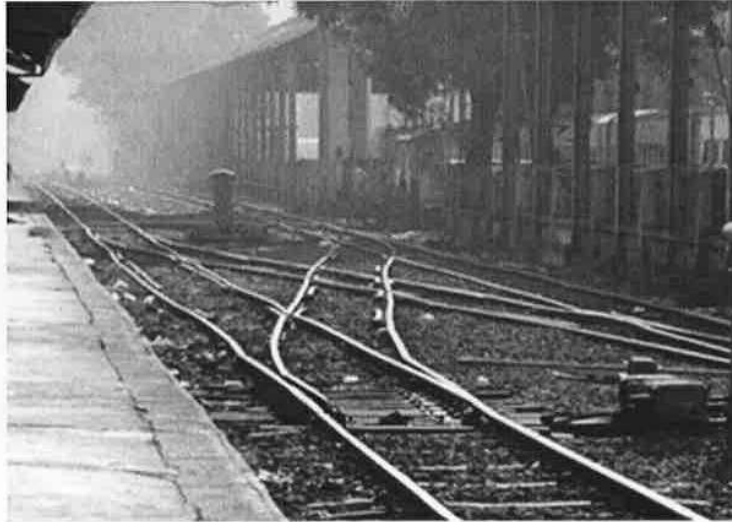
Main line turnout ကြီးကြီးမားမား ပြုပြင်ရမည်ပုံ။
