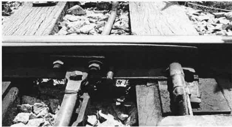
Tongue rail ထိပ်ပိုင်း Floor plate တွင်ဆီသုတ်လိမ်းထားမှုအခြေအနေ။
