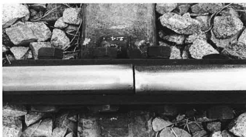
Joint Place ၏ batter ကွဲလွဲနေသောအခြေအနေ
